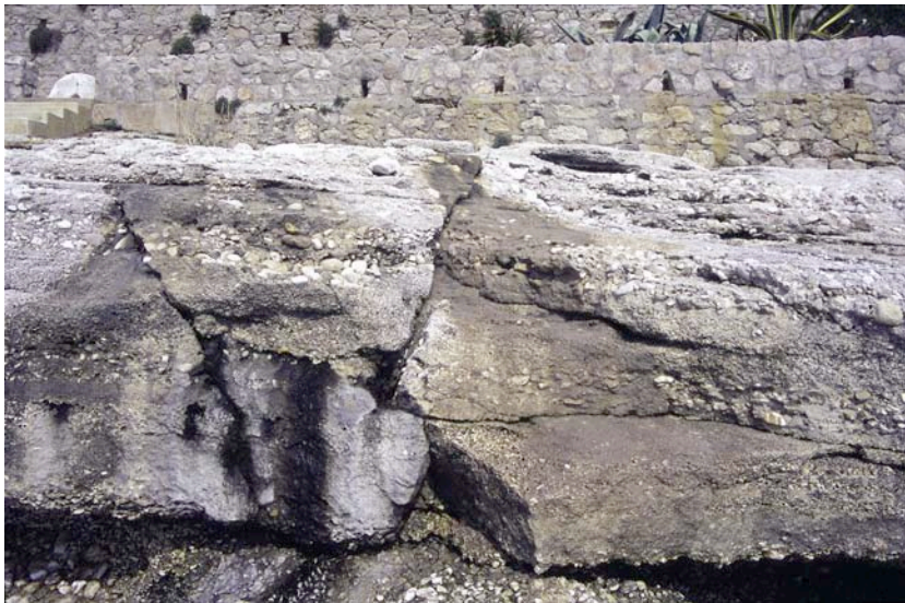
Fig. 3 La faille, vue en aval à la limite de l'éboulement. La meule traversée se trouve au-dessus, dans son prolongement.
